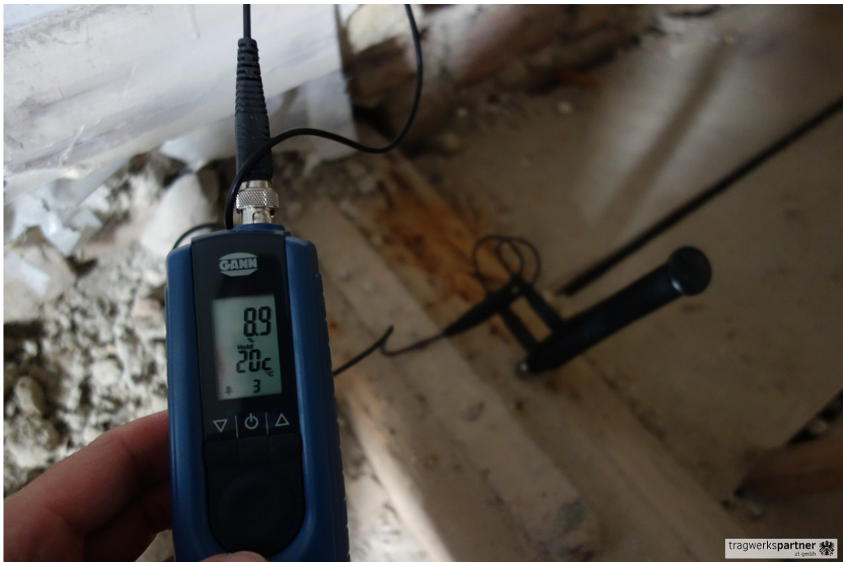
Abbildung 7: Holzfeuchtemessung im (geöffneten) Deckentram in Auflagernähe (Nord)
